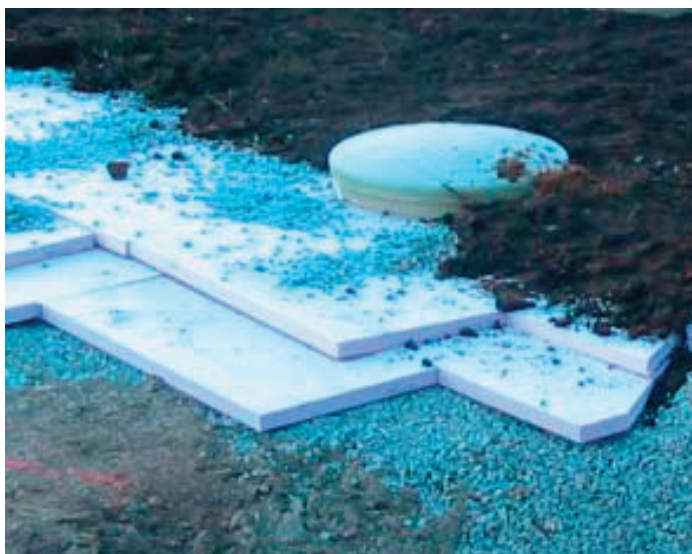
Frostsikring av tanker
